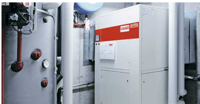
Pompe à chaleur air-air non soumise à l'octroi d'un permis de construire (prélèvement de l'air à l'intérieur du bâtiment)
