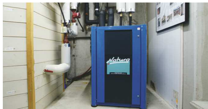
Pompe à chaleur sur sondes géothermiques non soumise à l'octroi d'un permis de construire
